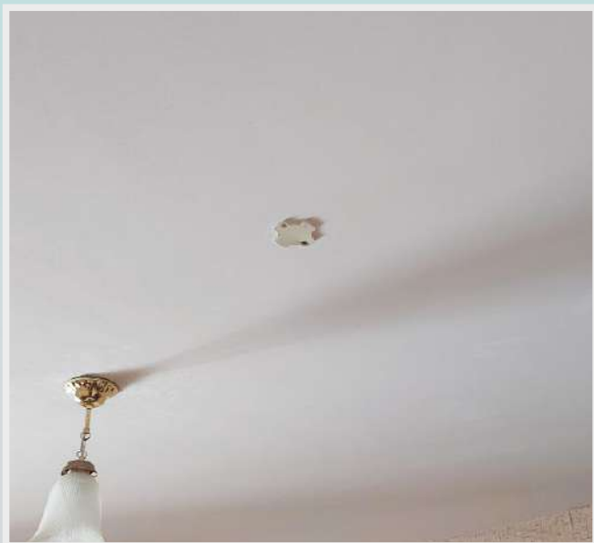
В жилых комнатах демонтированы автономные пожарные извещатели
